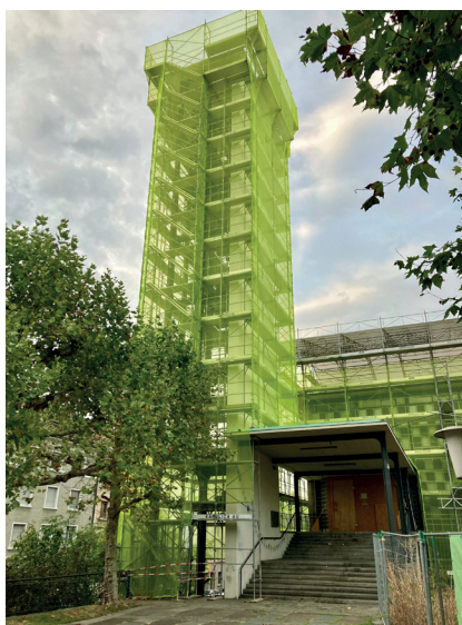
Der grüne Turm zu Basel: Ab Sommer 2024 war der Kirchturm des Johannes eingerüstet.
